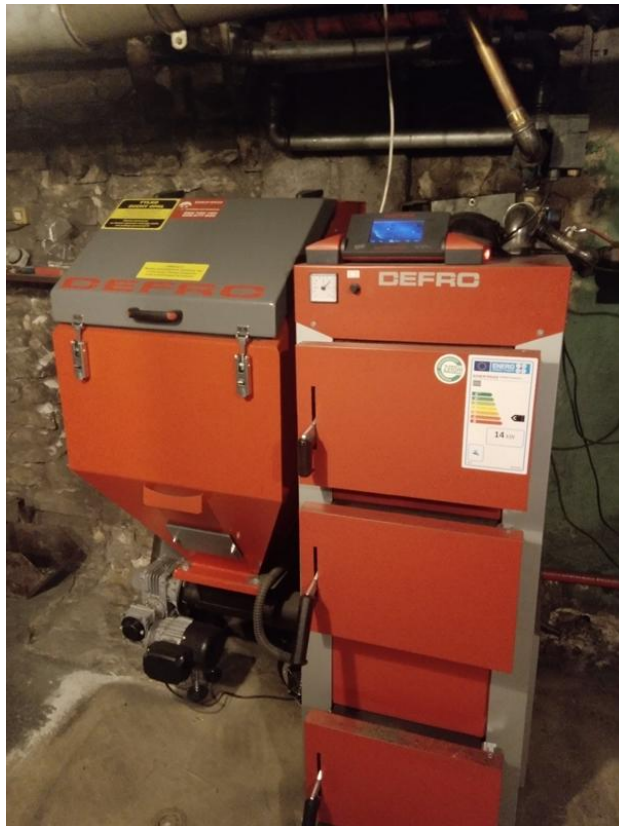
Zdjęcie: Kotły centralnego ogrzewania na paliwo gazowe lub stałe
