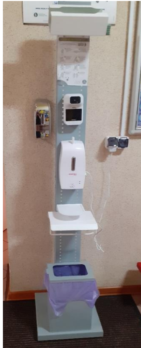
Zdjęcie: zamontowane bezdotykowe dozowniki płynu do dezynfekcji.
