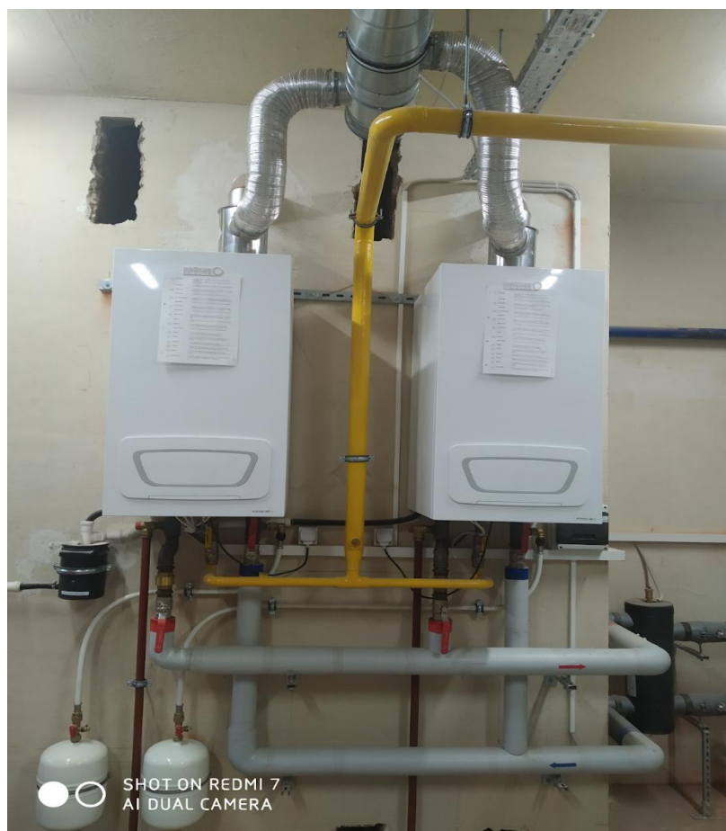
Zdjęcie: Kotłownia w „Trójbudynku”
