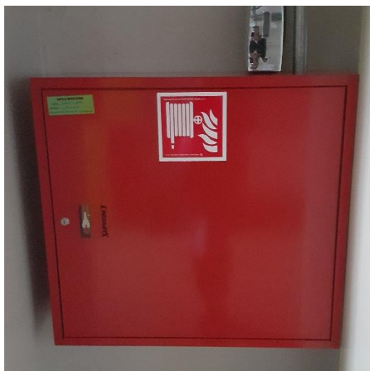
Zdjęcie: Hydrant wewnętrzny zamontowany w podziemiach
