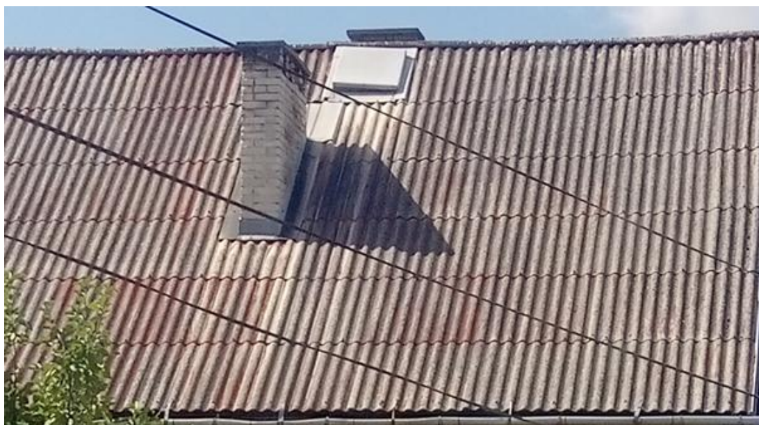
Zdjęcie: Dachy z pokryciem z azbestu
