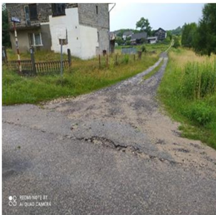
Zdjęcia: Uszkodzenie dróg gminnych w wyniku intensywnych opadów deszczu
