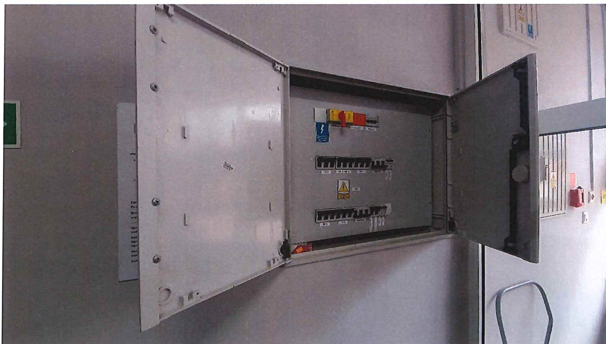
Zdjęcie rozdzielni w budynku
