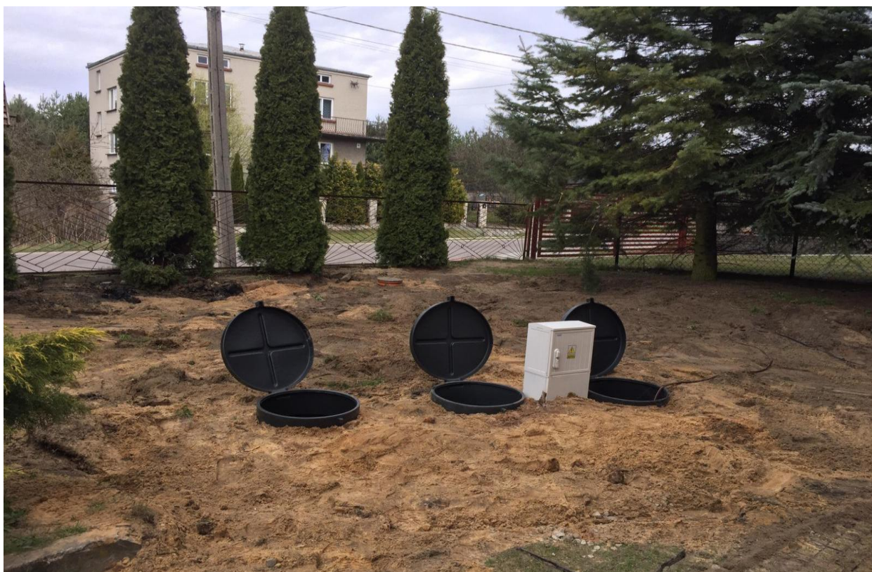
Przydomowa oczyszczalnia ścieków na posesji na terenie Gminy Ogrodzieniec
