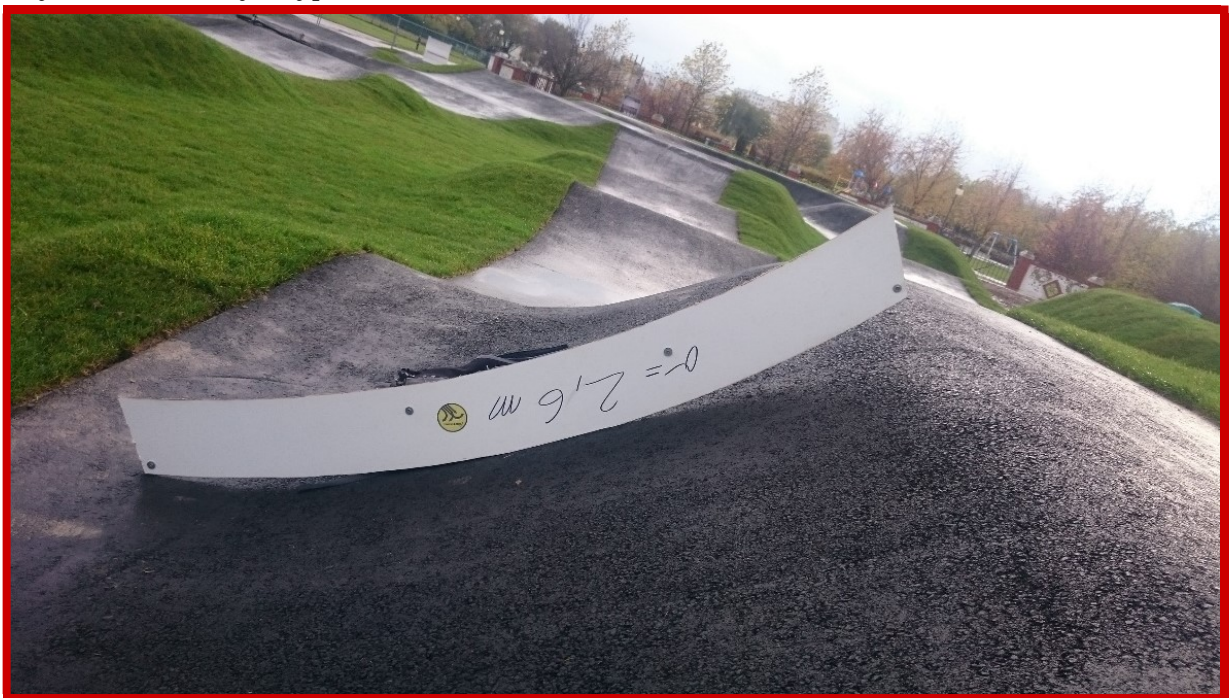
Nieprawidłowo wykonany zakręt profilowany, którego przekrój nie stanowi wycinka koła.
