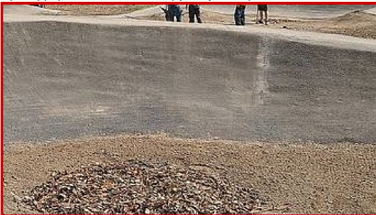
Nieprawidłowe połączenie nawierzchni jezdnej w miejscu przerwy technologicznej
