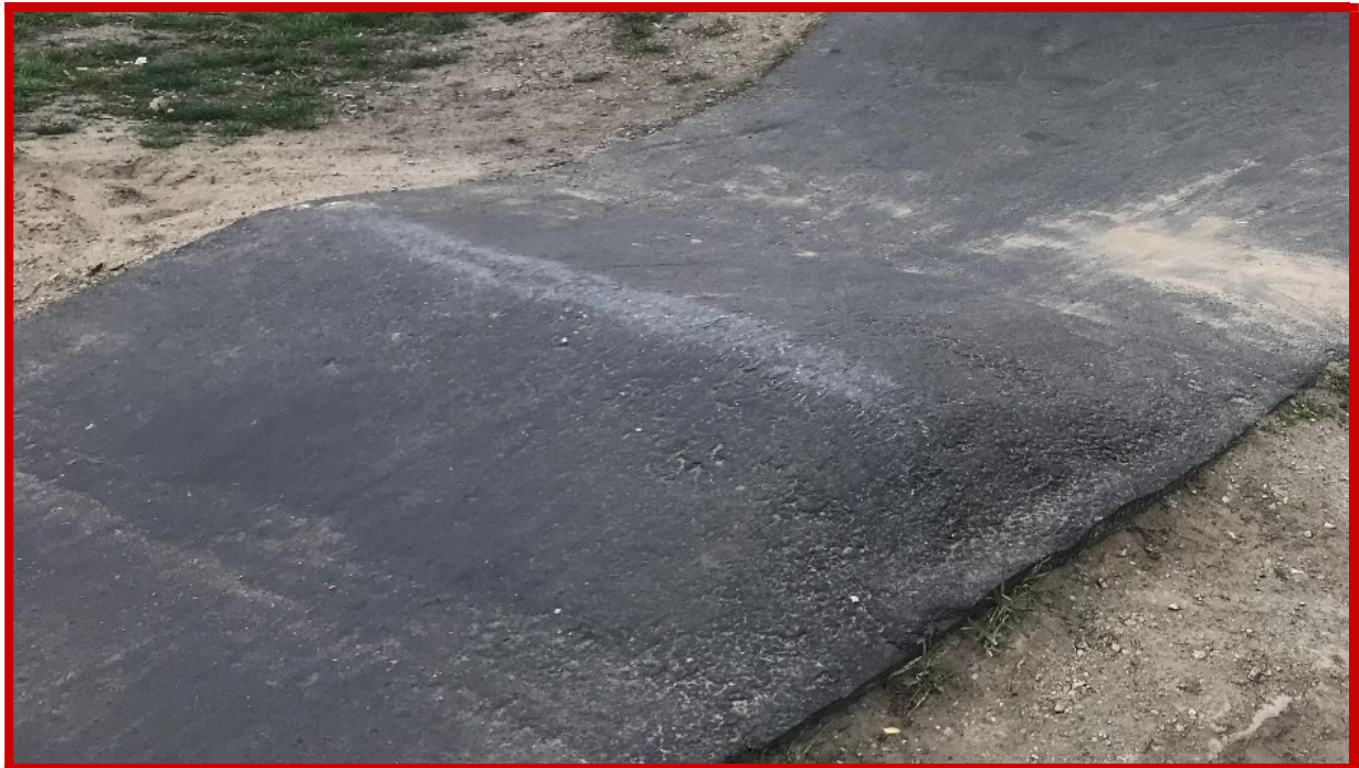
Niepoprawnie wykonany garb – o licznych nierównościach i złym kształcie
