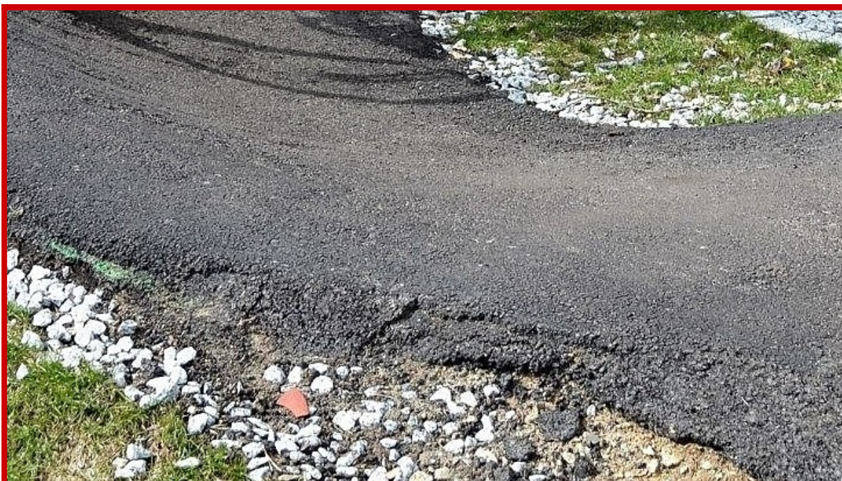
Nieprawidłowe wykończenie krawędzi nawierzchni jezdnej – nierówne, bez fazowania, z ubytkami i pęknięciami.
