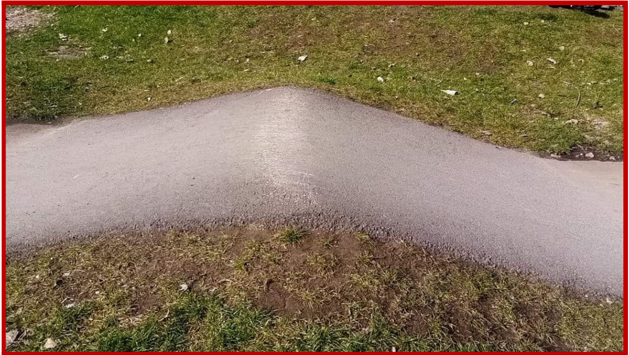
Niepoprawnie wyprofilowany garb – podjazd i zjazd płaski, szpiczasty kształt przeszkody
