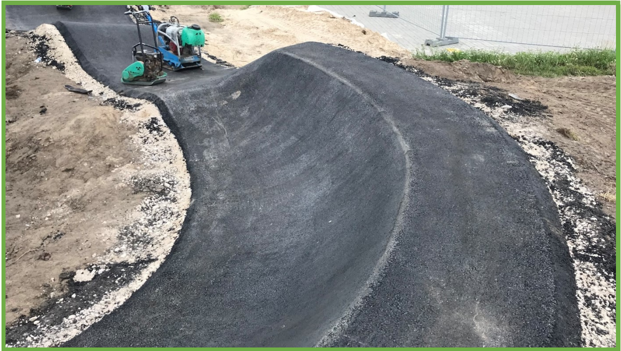
Prawidłowo wykonana nawierzchnia asfaltowa – jednorodna i gładka.
